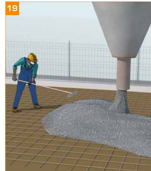
19 - Réalisation de la dalle béton après ferrailage et mise en place des incorporations. → Répartition du béton sur le coffrage sans surcharge des poutrelles et ST.
