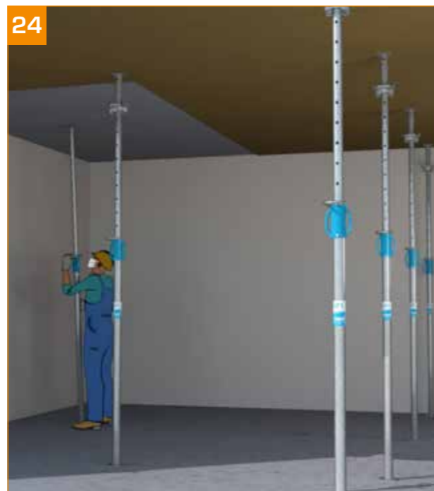
24 - Mise en place du premier étau de séchage en respectant un étau pour 5 m 2 (cas général).
