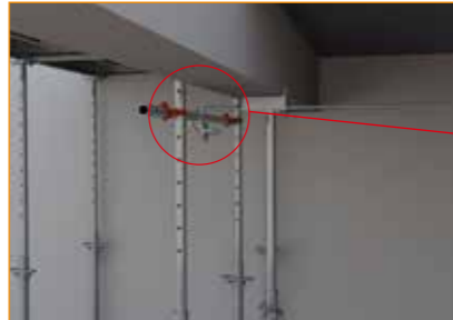
- Mettre en place la stabilisation des premiers éléments. Une fois la stabilisation en place il est possible de retirer les trépieds.
